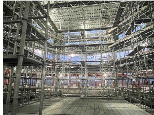
【久御山町全世代・全員活躍 まちづくりセンター建築工事】
